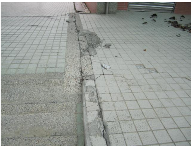
廚房前地面龜裂
