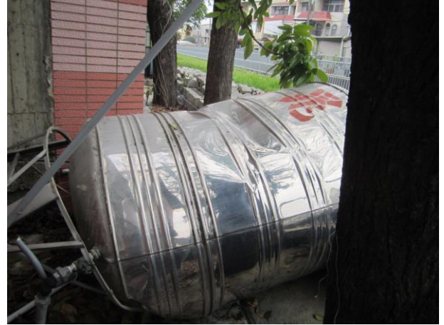
水塔倒塌損壞
