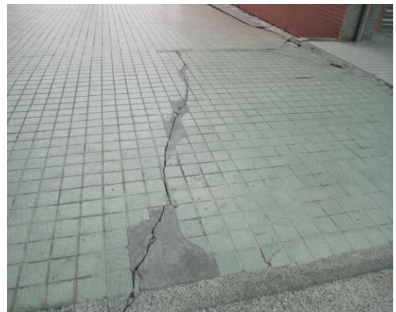
廚房前地面龜裂
