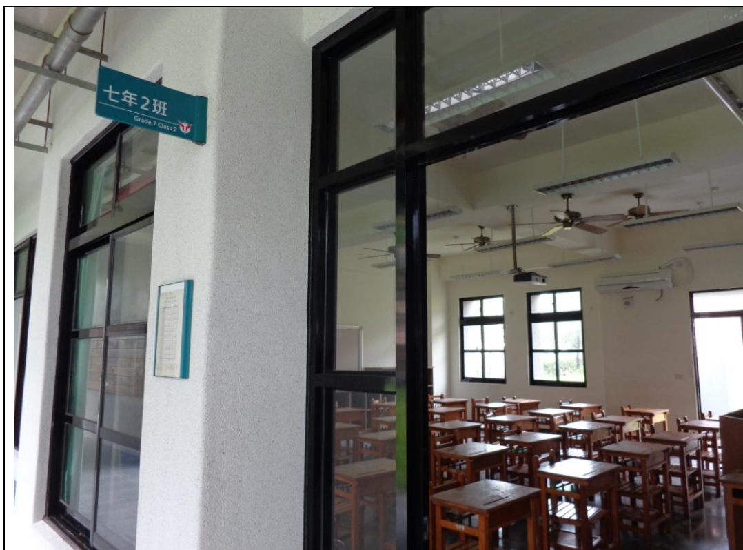
空調設備（原班教室 1 台）
