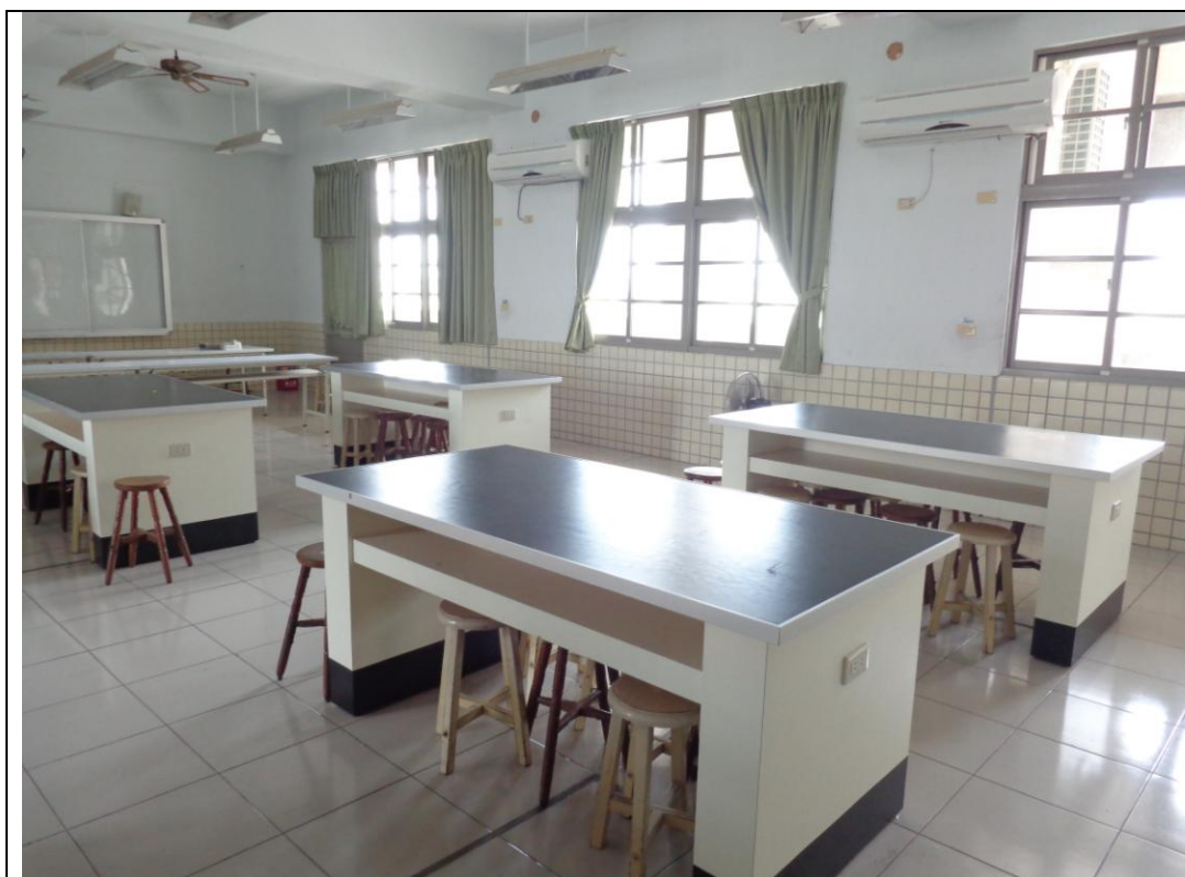
空調設備（生物教室 2 台）
