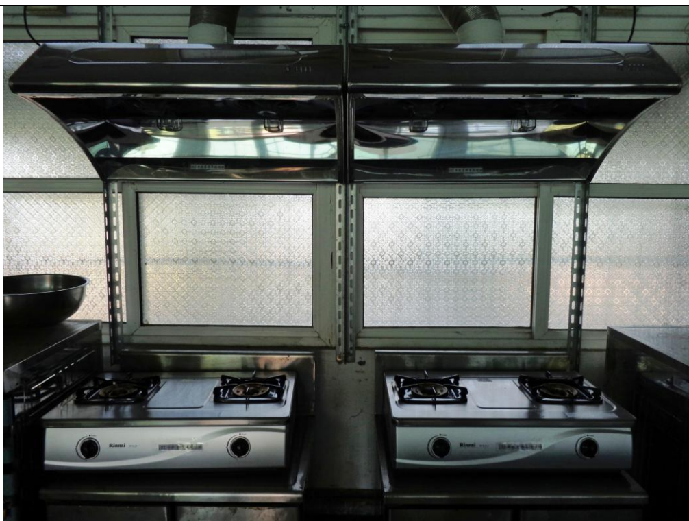
③ 2 台瓦斯爐及 2 台排油煙機
